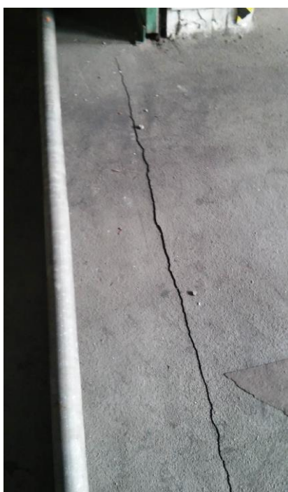
Trhliny v podlaze
